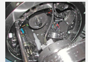
Defekte Drehdurchführung und Folgeschäden
